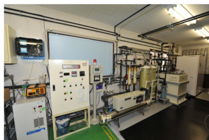
自社 R&D センター超純水製造設備
